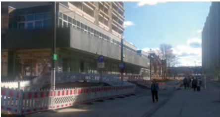
Gesperrte Fahrradtrasse in der Löderstraße
